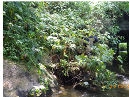
図 2 排水路壁の崩壊状況
