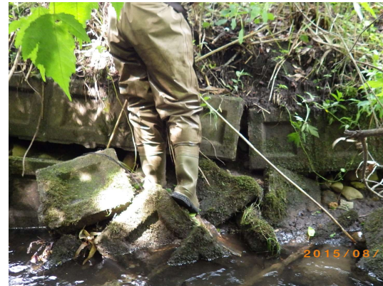
図 1 排水路壁ブロックの崩壊状況
